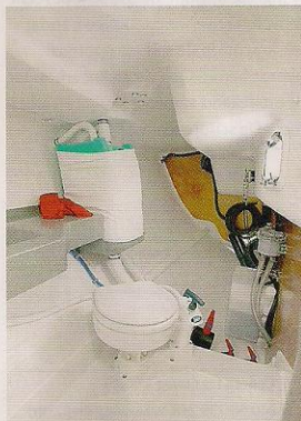
De afsluiters bevinden zich in de toilet ruimte.
